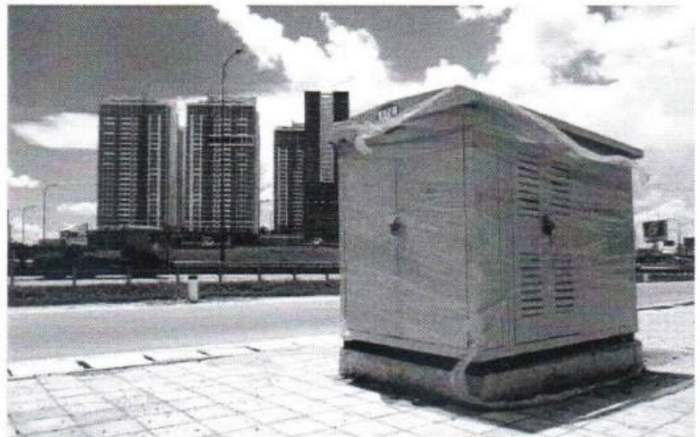
Các trạm biến áp trung thế cho dự án ngầm hóa lưới điện
